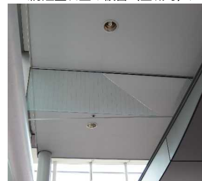
<防煙垂れ壁の被害（益城町）>
