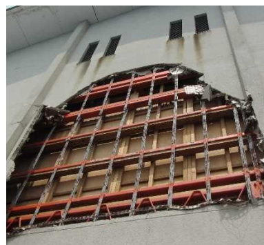
<外装材の脱落（熊本市）>
