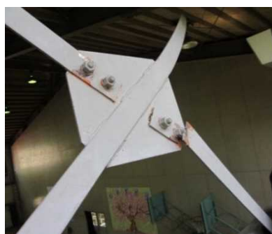
<鉛直ブレースの破断（熊本市）>
