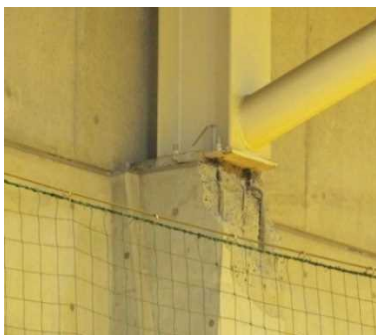
<屋根支承部の破壊（熊本市）>
