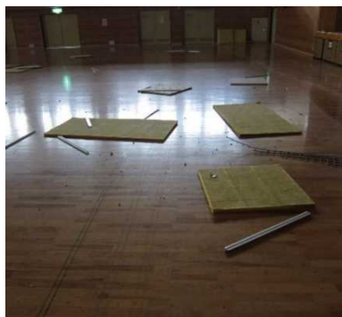
<天井材の落下（合志市）>
