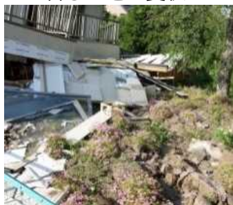
<著しい地盤変状>
