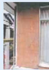
外壁側から筋かいや構造用合板により補強(外壁仕上工事費を含む)
